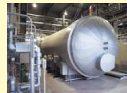
生ごみをエネルギーに変える施設(メタン発酵施設)
