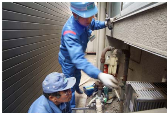
ガス機器の点検作業
